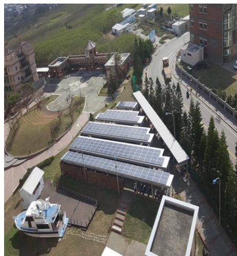
圖 1-3-3 機車停車場棚頂太陽光電系統設備
