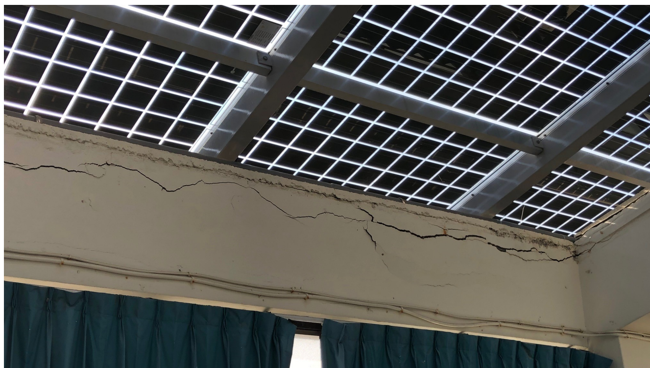
大梁結構性裂縫損壞
