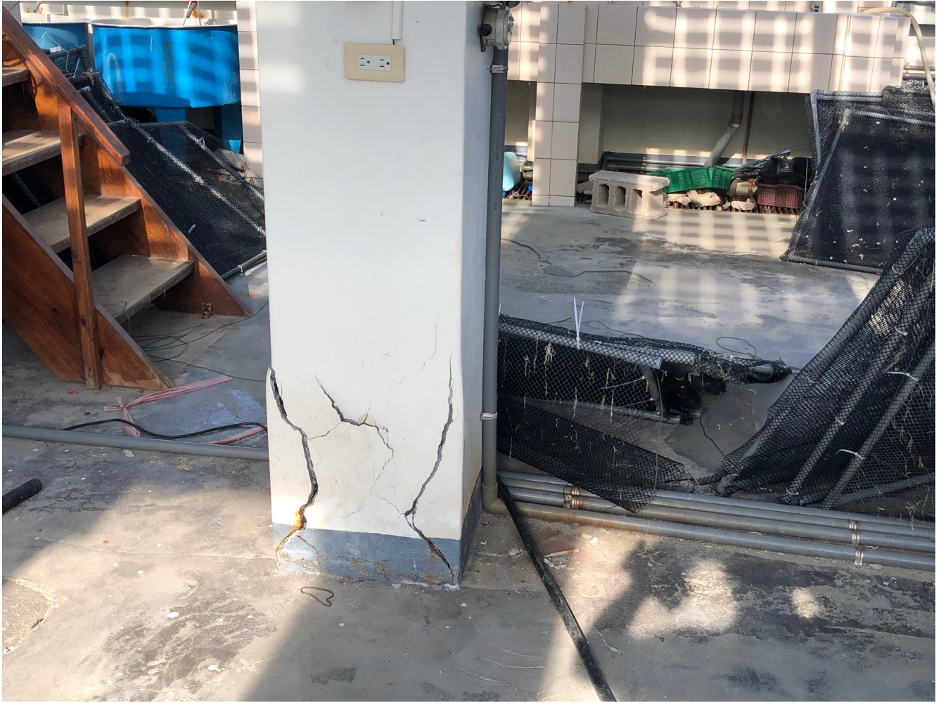
中間柱挫曲爆裂
