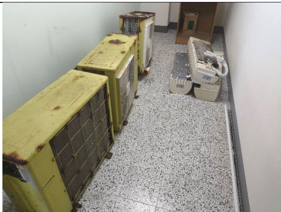
冷氣機 3 台(電機系 MN402-1)
