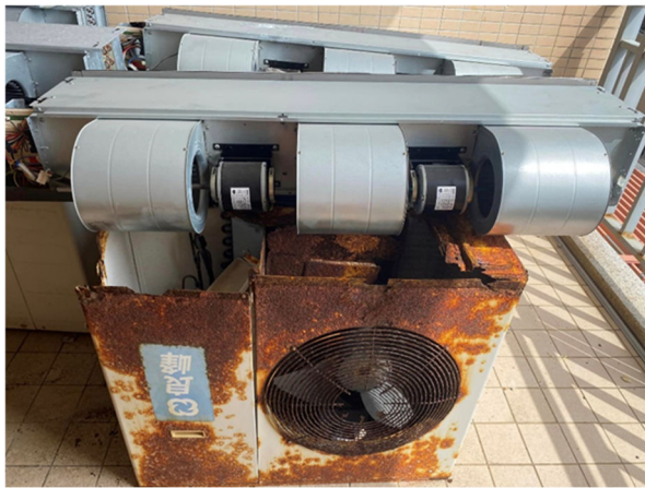
分離式冷氣機 5010106-03-10723(資管系研究室 走廊陽台)
