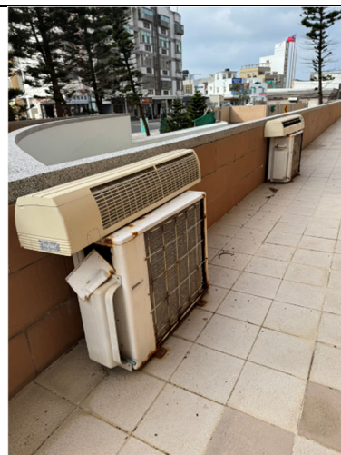
分離式冷氣機 5010106-03-7877(實 習商店外側)2 台
