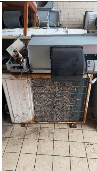
分離式冷氣機_0010537A0057(6樓陽台)
