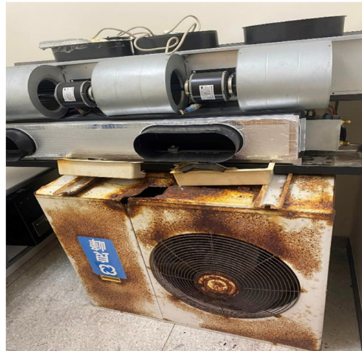
分離式冷氣機 5010106-03-10724(資管系研究室走 廊陽台)
