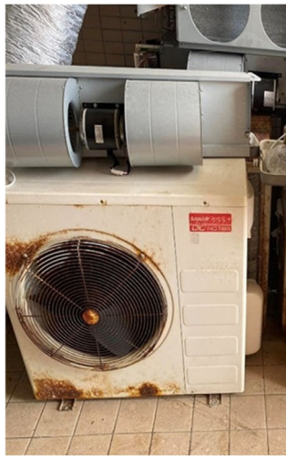
分離式冷氣機 5010106-03-10539(資管系研究室 走廊陽台)
