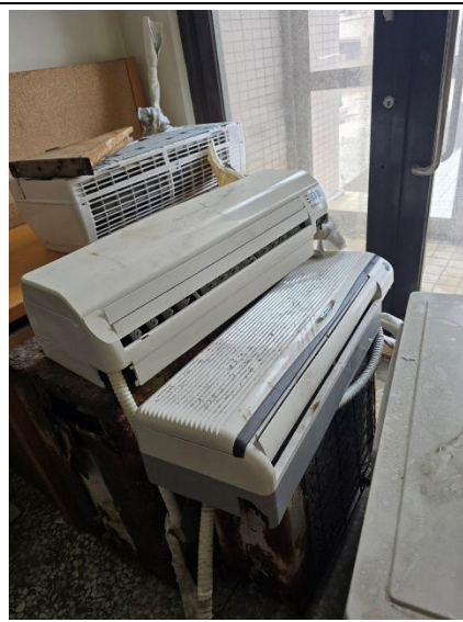
分離式冷氣機 4 台(圖資館 1F)
